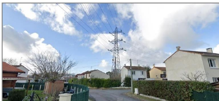
Figure 4 : Liaison à double terne 225 000 / 63 000 volts sur la portion Sud PESSAC - piquage GARIES (RTE, 2023)
