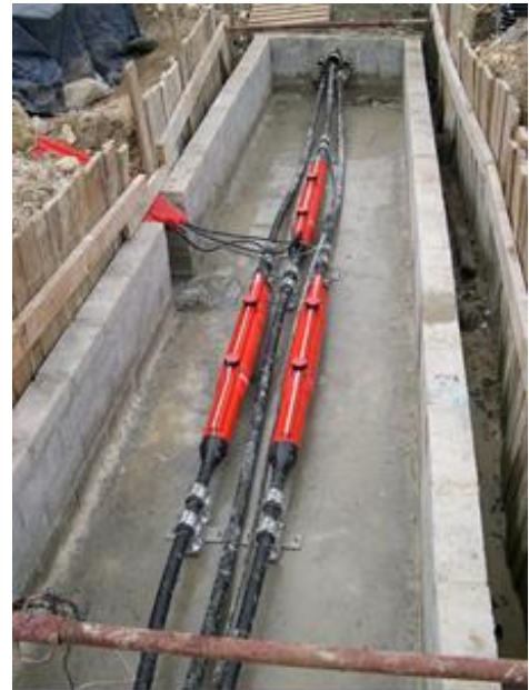
Figure 18 : Photo de chambre de jonction avant refermeture (RTE)
