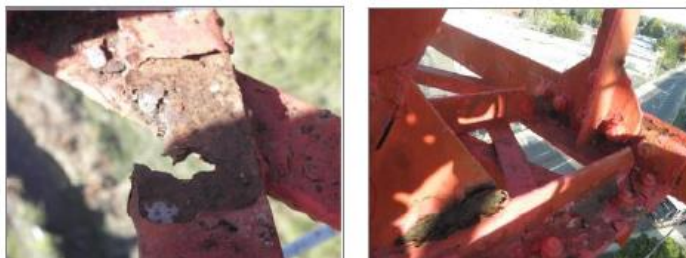
Figure 3 : Exemples de corrosion des supports en acier noir (RTE, 2023)
